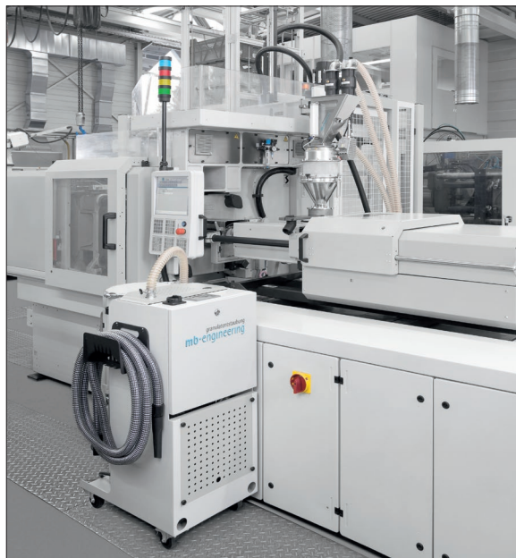
Granulat-Entstauber TS5 auf ARBURG® Spritzgussmaschine
